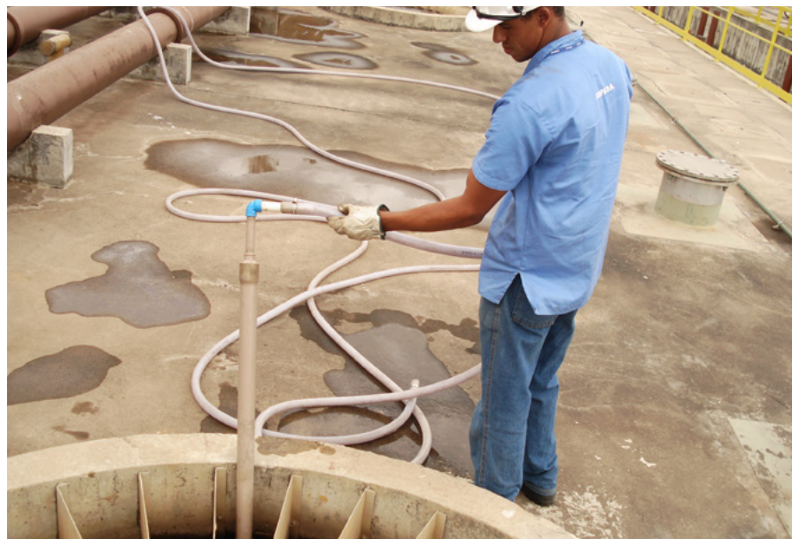
Figura 3.19: Foto de um procedimento manual de desobstrução das tubulações de entrada de esgoto sanitário de um reator UASB.
