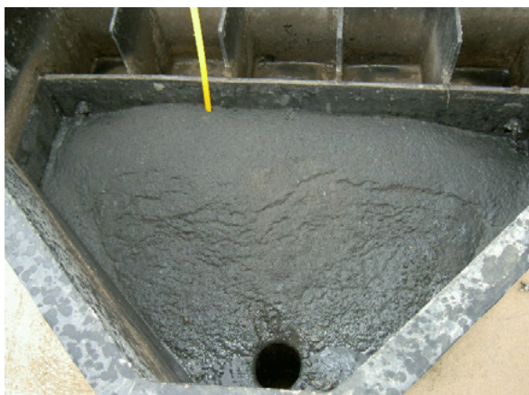
Figura 3.5: Acúmulo de areia na caixa de distribuição de efluente dos reatores UASB.
