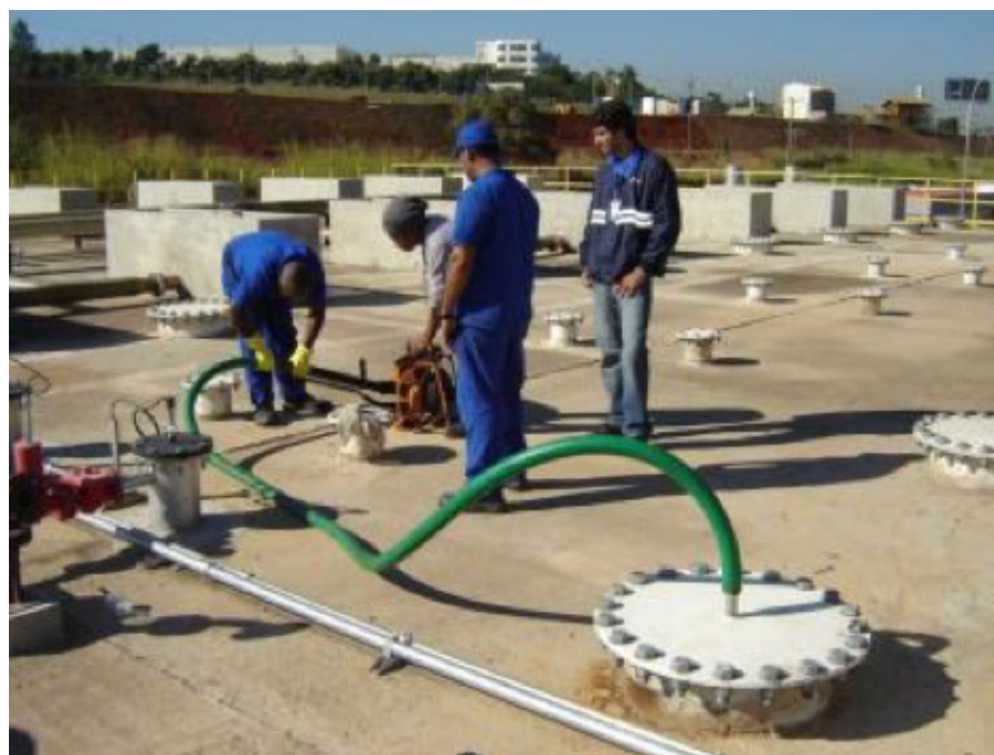
Figura 3.14: Foto de procedimento de verificação da estanqueidade do reator UASB a partir da injeção de fumaça.
