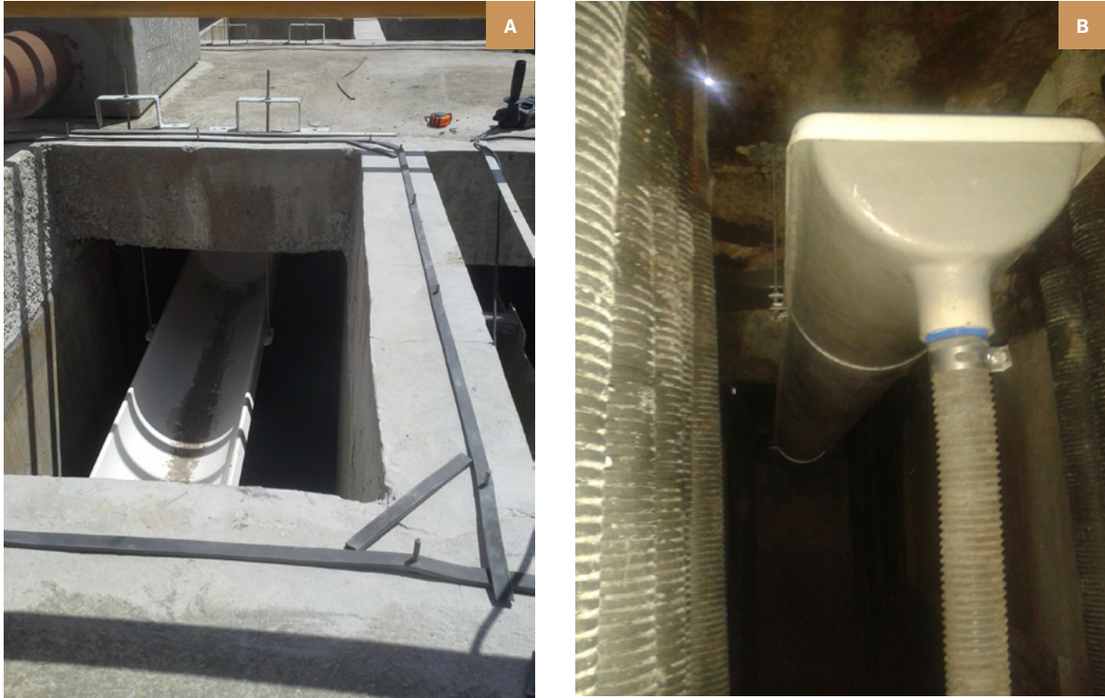
Figura 3.10: Calhas de remoção de espuma com ajuste de nível implantadas na ETE Jacuípe II: (a) vista superior; (b) vista interna do reator.
