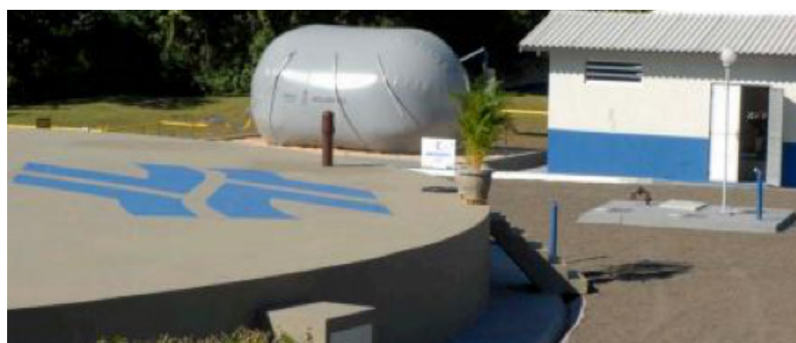
Figura 9.5: Foto do sistema de geração distribuída de energia elétrica da ETE Ouro Verde/Foz do Iguaçu movido a biogás.
