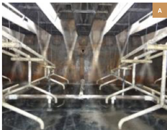
Figura 3.2: Fotos de reatores UASB: [a] interior; [b] cobertura; [c] visão aérea de reatores UASB.
