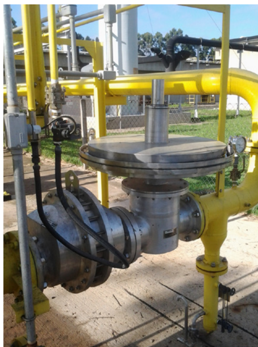
Figura 5.4: Foto de uma válvula reguladora de pressão (ao centro) instalada em um gasoduto (em amarelo).
