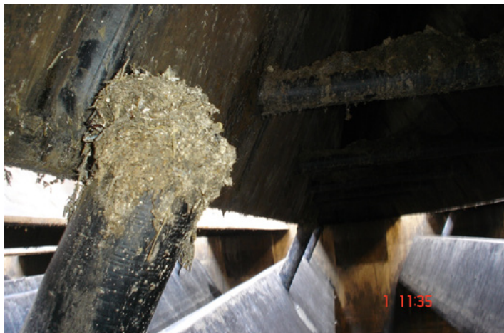
Figura 3.12: Foto da obstrução da tubulação de coleta de biogás devido à presença de espuma.
