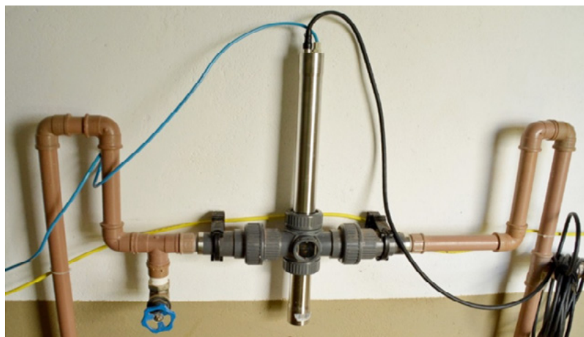
Figura 4: Instalação completa do carbo::lyser em by pass com sifão duplo.
