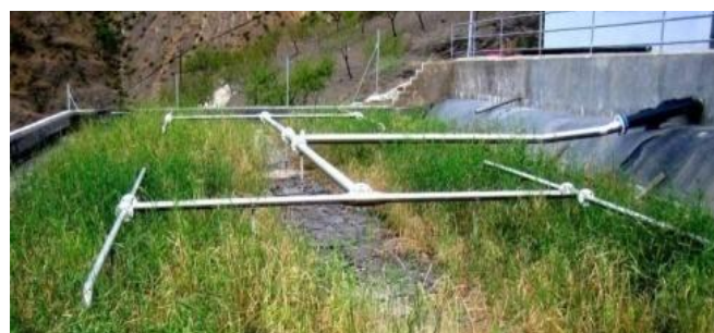
Figura 26. Tuberías de distribución de las aguas residuales sobre el lecho de pretratamiento del sistema Francés, Albondón, España (foto T. Burkard, AKUT, 2007).
