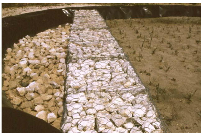
Figura 20. HFH con dique de piedras en la zona de entrada que ayuda con la distribución e infiltración del agua a tratar, cerca de Leiria, Portugal (foto J. Vymazal, 2003).
