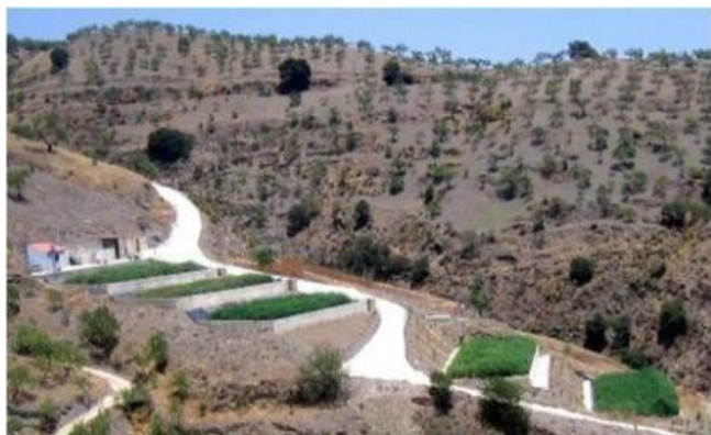
Figura 24. Sistema Francés para 800 PE, de izquierda a derecha: tres HFV (filtros) para el pretratamiento y dos HFV para el tratamiento secundario en Albondón, España. La planta no necesita suministro de electricidad, ya que está construida en pendiente (foto T. Burkard, AKUT, 2005).
