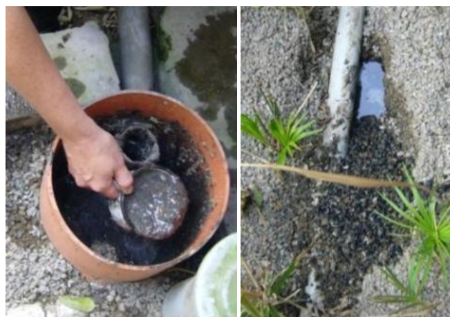
Figura 28. Izquierda: Mal funcionamiento de la trampa de grasa con acumulación de lodos en exceso. Derecha: los lodos de la trampa de grasa obstruyen la zona de infiltración del HA, el color negro se da porque no hay transporte de oxígeno lo que lleva a la obstrucción (fotos H. Hoffmann, 2009, Lima, Perú).
