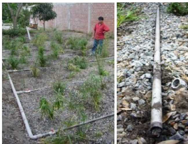
Figura 29. Izquierda: Limpieza de las tuberías de distribución de agua residual por medio de la apertura y cierre de válvulas durante la fase de bombeo (plantas de papiro paraguá después de un proceso de replantado). Derecha: Tapa abierta en una tubería de distribución obstruida (fotos H. Hoffmann, 2009, Lima, Perú).
