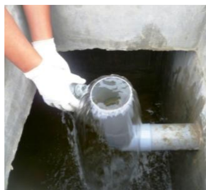
Figura 11: Efluente final (saída do dreno, entrada reservatório)
